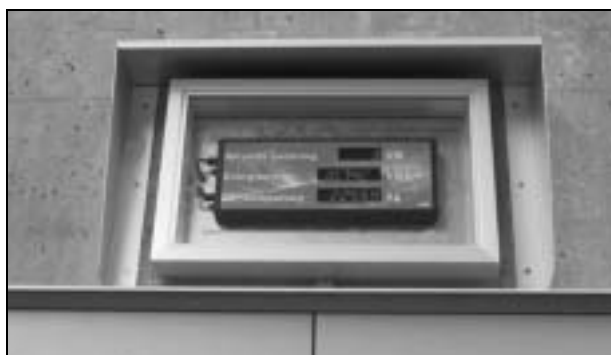
Fig. 6 Die zusätzlich über dem Schaltschrank montierte Leuchtanzeige mit 3-Zeilen-Display.
