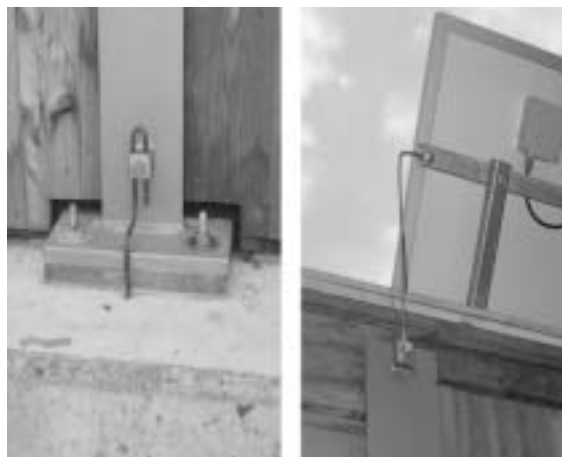
Fig. 13 Durchgehender Blitzschutz - Anschlüsse unten und oben - sichern die Anlage gegen allfällige Blitzeinschläge.
