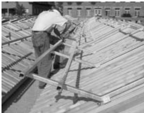
Fig. 9a Vormontage der Tragkonstruktion für die Aufnahme der Photovoltaikmodule. Stand der Arbeiten am 12. Sept. 2000.
