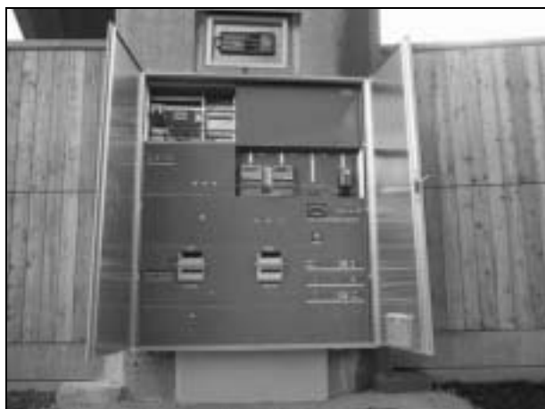
Fig. 5 Hauptschaltschrank mit eingebautem Datenlogger und Modem zur Datenfernabfrage.
