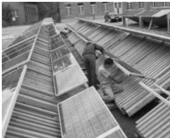
Fig. 9b Vormontage der PV-Module auf die vorgängig angebrachte Tragkonstruktion. Stand der Arbeiten am 2. Okt. 2000.
