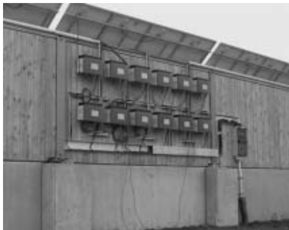
Fig. 10 Ansicht auf die Wechselrichtergruppe Wand West und darüber verlaufendem Kabelkanal. Stand der Arbeit am 10. Nov. 2000.
